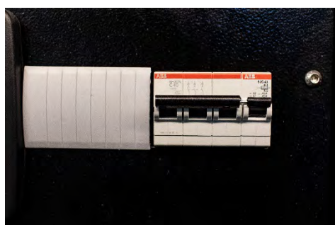
Электрическая часть электростанции АВВ
